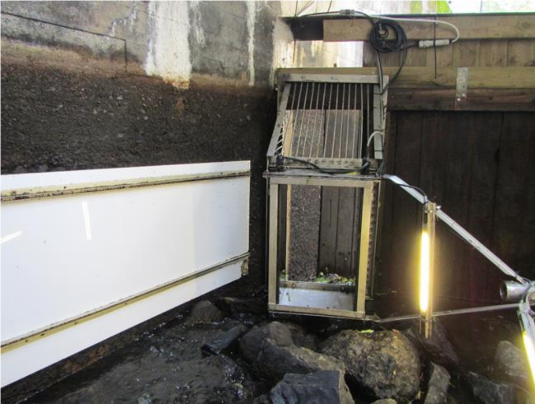
Kuva 1. Koivukosken säännöstelypadon kalaportaaseen asennettu Vaki-kalalaskuri, ohjauskehikko sekä kalojen lajintunnistuksessa apuna käytetty videokamera valoineen.
