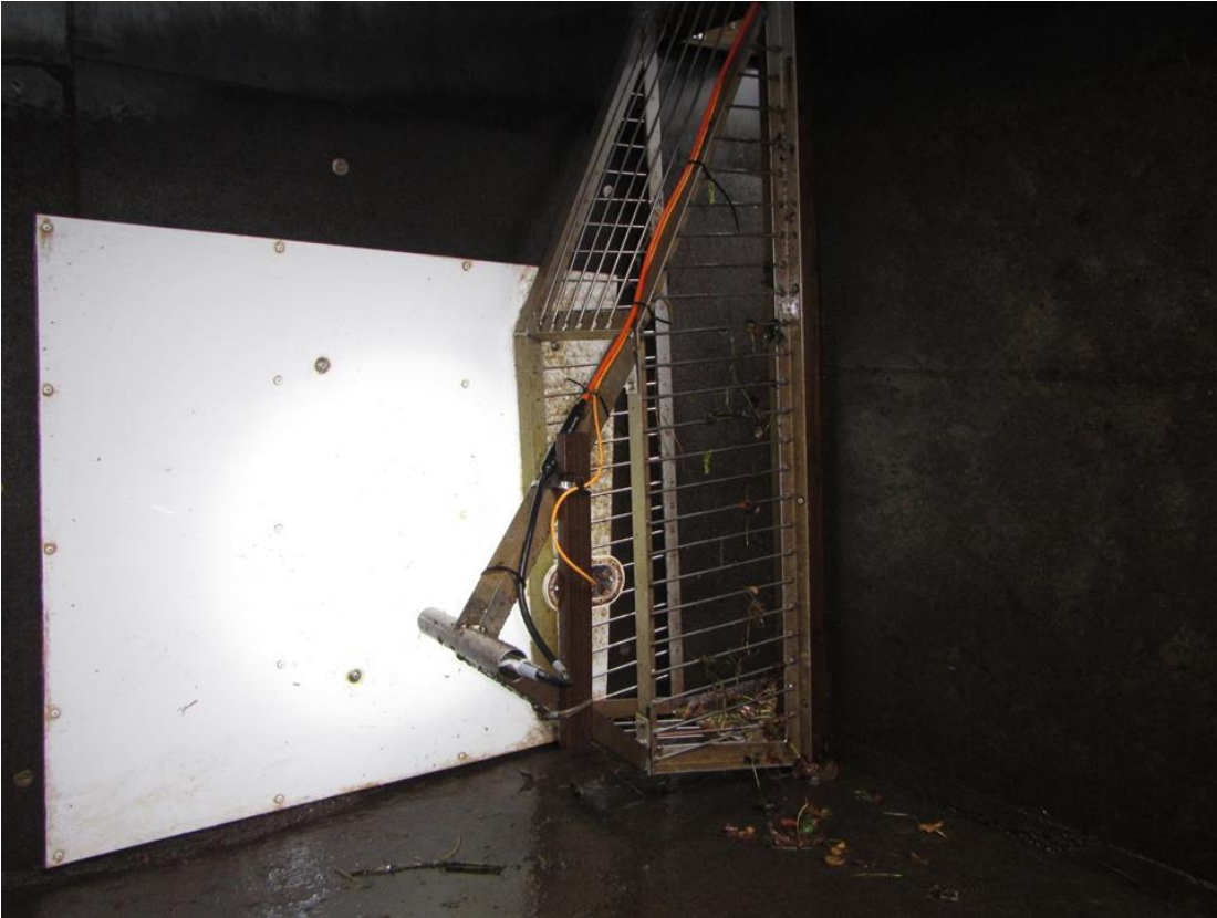
Kuva 4. Korkeakosken seurantalaitteisto asennettuna kalaportaan ylimpään altaaseen.
